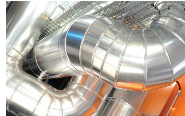
Foto: Haselbacher Nahwärme
